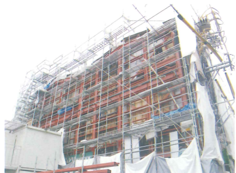
カッセイ食品 株式会社 様(名古屋) ●工場の外側(工場内部のレイアウトの変更なく)から耐震補強対策を行い、働く社員を守る。
